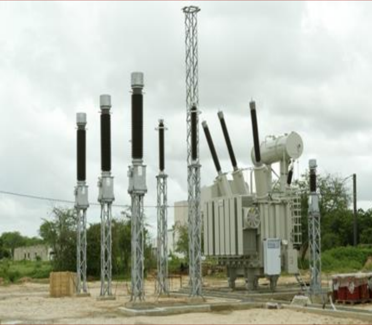
پست های ۲۲۰ کیلوولت اتیوپی
