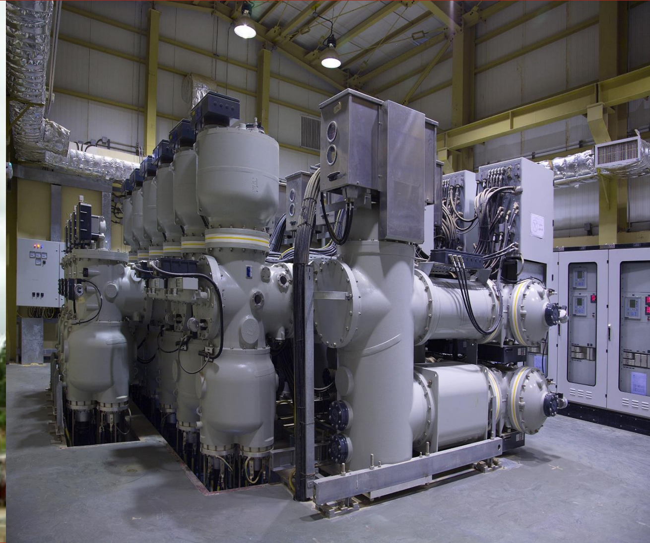
پست ۴۰۰ کیلوولت GIS نیروگاه الصدر عراق
